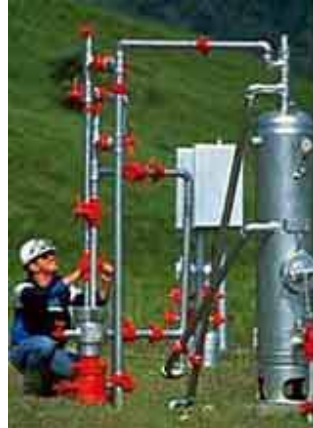
Kad je pritisak još uvek dovoljno veliki plin dolazi na površinu kroz sistem cevi nazvan "božićno drvce".
